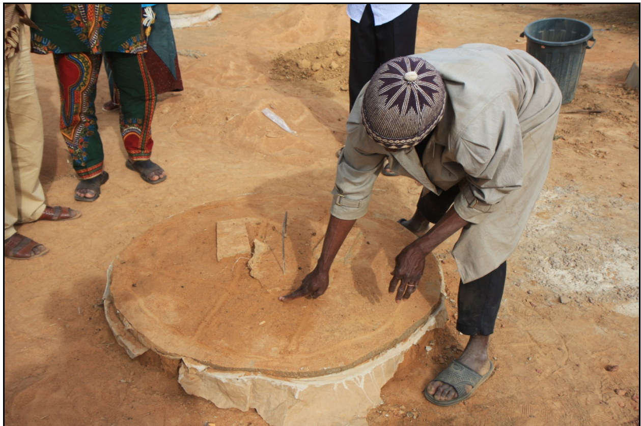
Les maçons apprennent à construire des dalles Sanplat pour la construction de latrines familiales dans les zones rurales du Mali.
